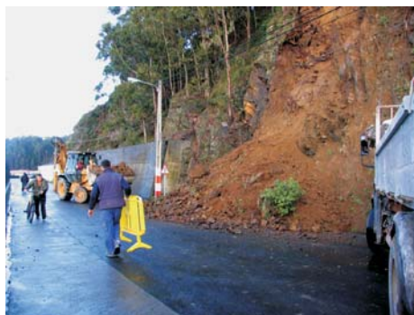
Esborrallamento no porto de Cedeira fronte ao carro baradero
